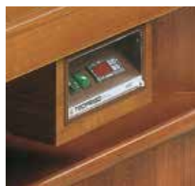
Painel de controlo com termóstato e termómetro digital.
