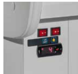
Quadro de controlo com termóstato.
